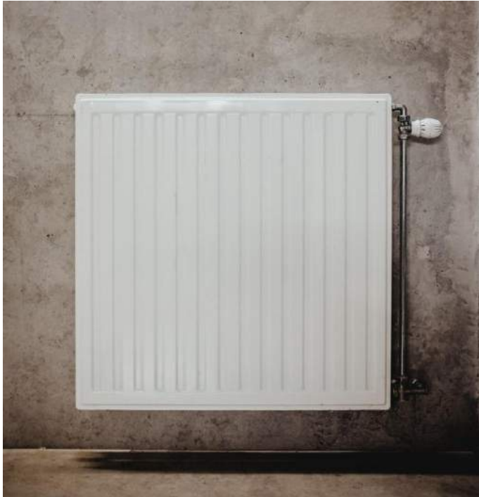
Heizung fällt aus
